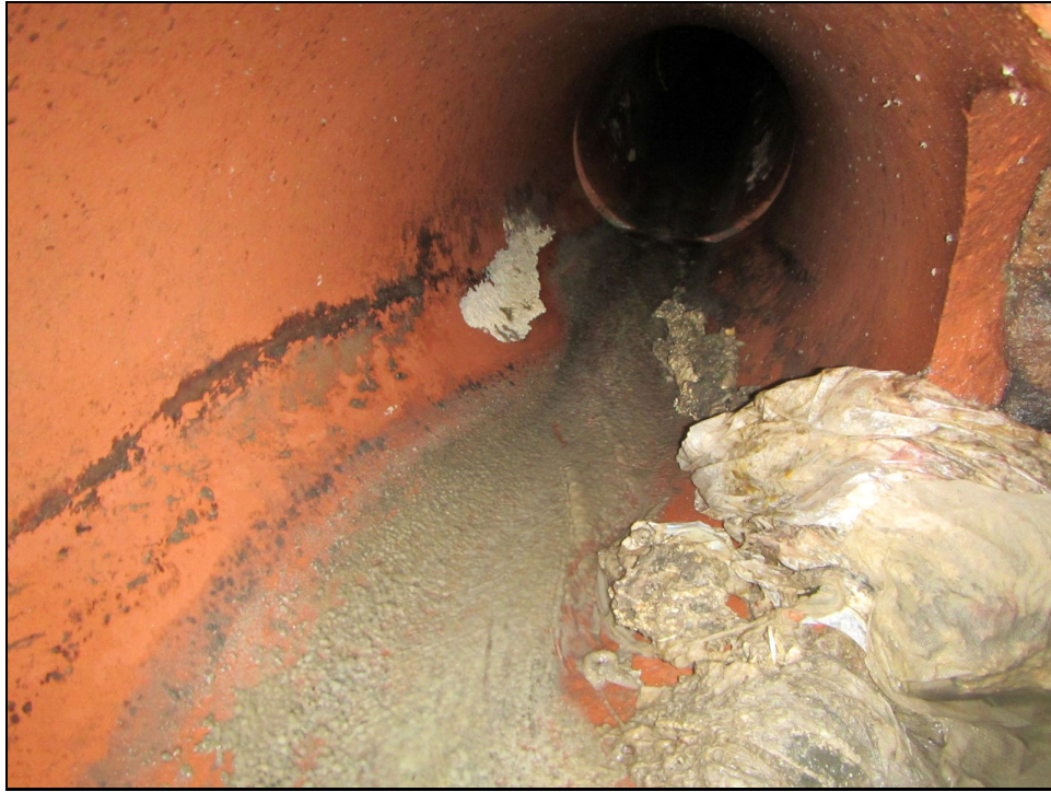
North Effluent Pipe
